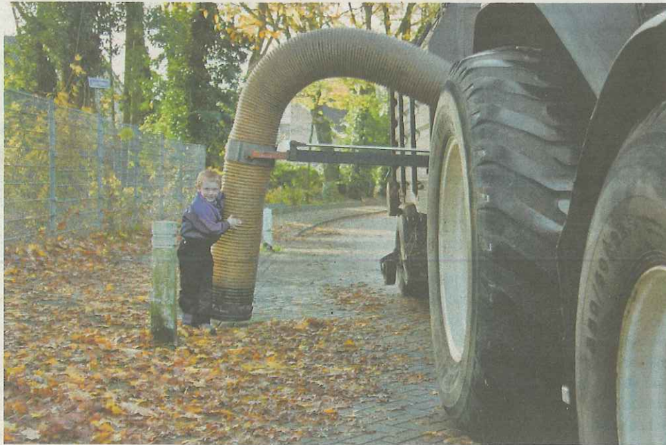
Op zaterdag 26 november werkte bewoners van de Oranjebuurt, firma van de Haar Groep, Firma Vaarkamp en Wijkbeheer van de gemeente Ede hard aan het schoonmaken van de wijk.
